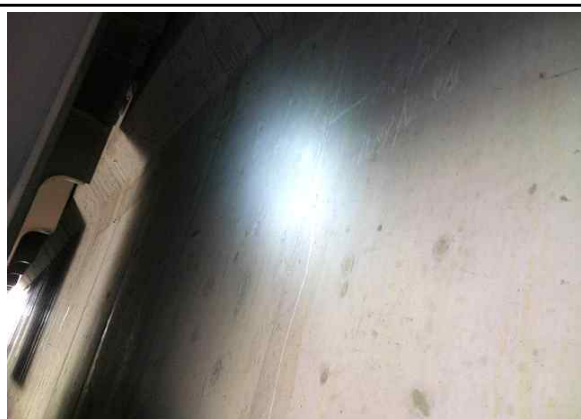
A2 홍벽 균열(폭 0.2mm)
