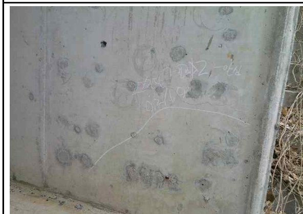
A2 홍벽 균열(폭 0.2mm)
