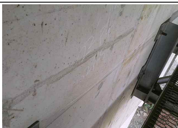
P4 코핑부 균열(폭 0.2mm)
