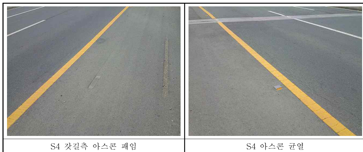
&lt;표 3.22&gt; 범물방향 교면포장 외관조사 결과
