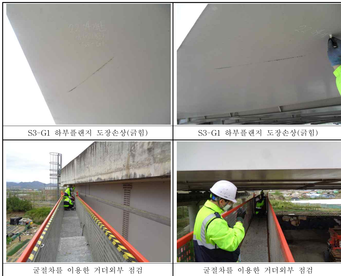
<표 3.2> 범물방향 거더 외부 외관조사 결과
