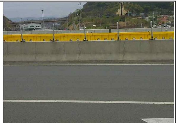
S2 중앙분리대 균열(폭 0.2mm)
