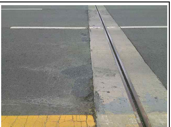
S4(P3) 아스콘 파손
