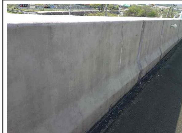
S2 방호벽 균열(폭 0.2mm)
