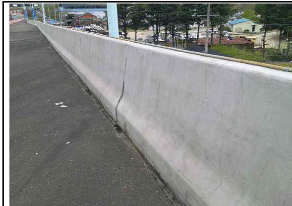
S2 방호벽 균열(폭 0.2mm)
