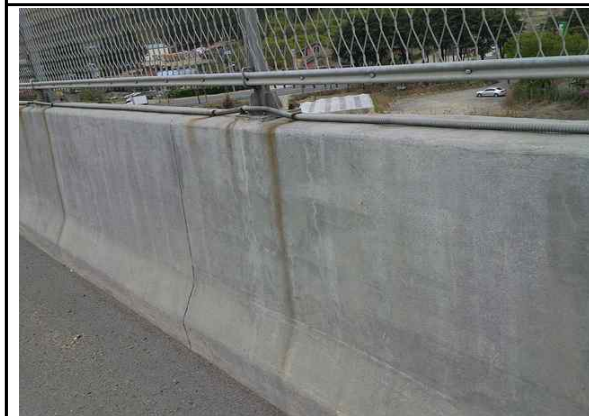
S4 방호벽 균열(폭 0.2mm)
