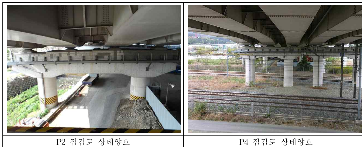
<표 3.58> 안심방향 점검시설 외관조사 결과
