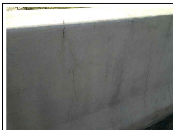
S1 방호벽 균열(폭 0.2mm)
