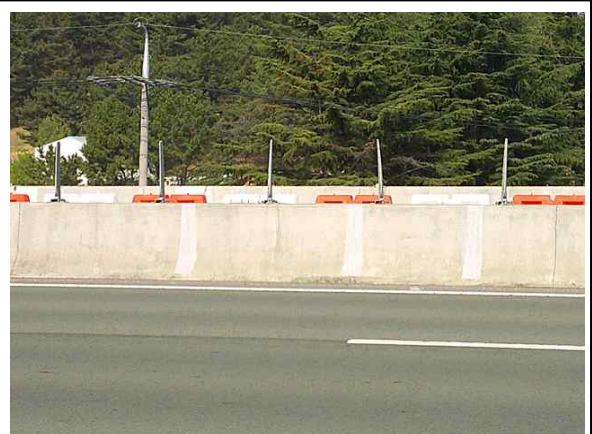
S2 중앙분리대 균열(폭 0.1mm)
