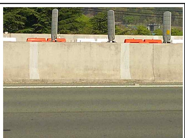
S1 중앙분리대 균열(폭 0.1mm)
