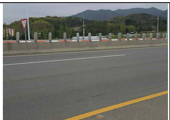
S1 중앙분리대 균열(폭 0.2mm)
