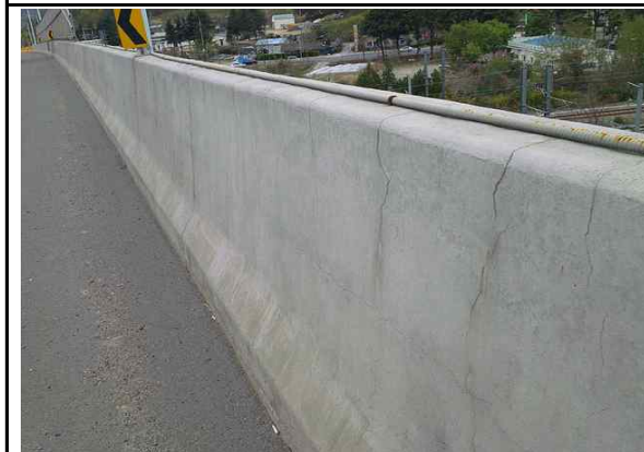
S5 방호벽 균열(폭 0.2mm)
