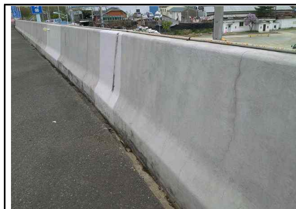
S1 방호벽 균열(폭 0.2mm)
