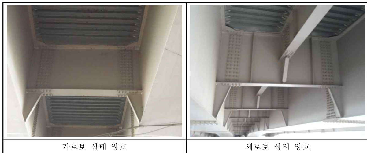
<표 3.6> 범물방향 가로보 외관조사 결과
