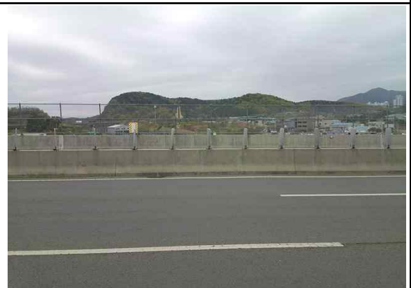
S4 중앙분리대 균열(폭 0.2mm)
