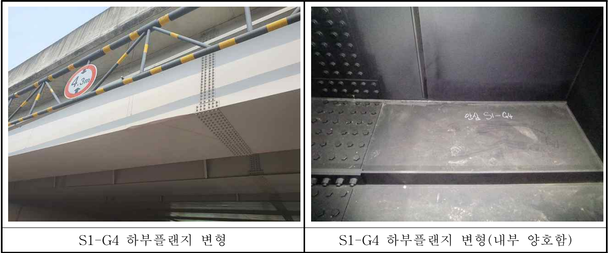
<표 3.32> 안심방향 거더 외부 외관조사 결과
