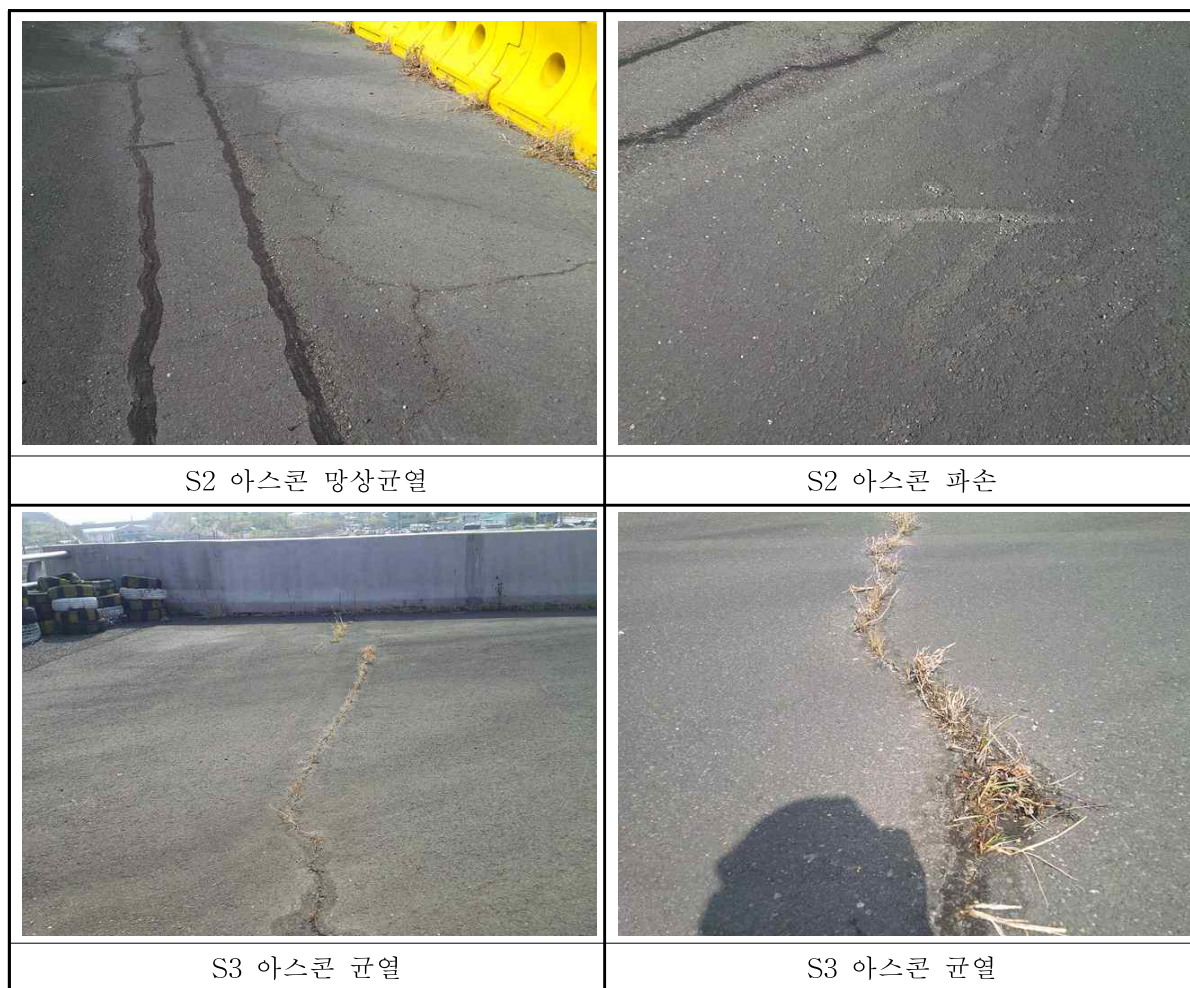
&lt;표 3.52&gt; 안심방향 교면포장 외관조사 결과
