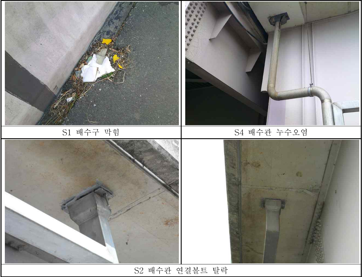
<표 3.54> 안심방향 배수시설 외관조사 결과
