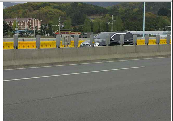
S3 중앙분리대 균열(폭 0.2mm)
