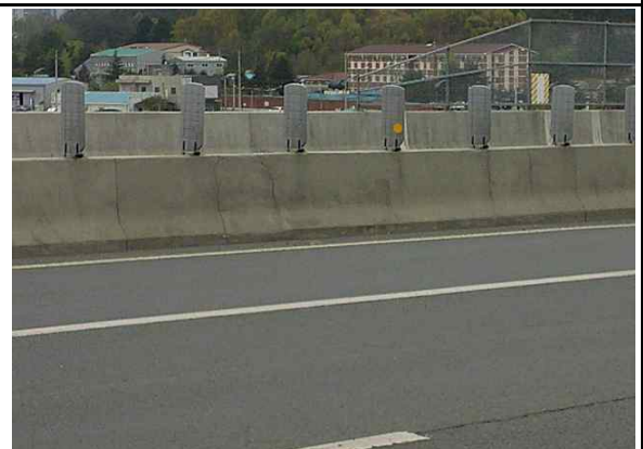
S5 중앙분리대 균열(폭 0.2mm)
